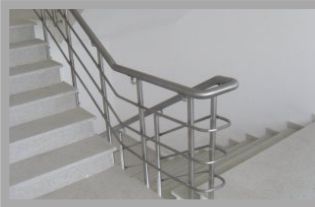
Q51lik küpeşte borulu, Q38 lik dikme borulu, Q16 lik yatay emniyet kayıtlı, "L" konsollu ve yandan bağlantılı korkuluk uygulaması
